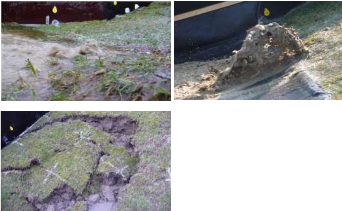
Figuur D.5 Uitspoelen van zand door een molgang onderaan het talud, gevolgd door ondermijning van de kleilaag en falen van de bekleding (Golfoverslagproef Tholen).
