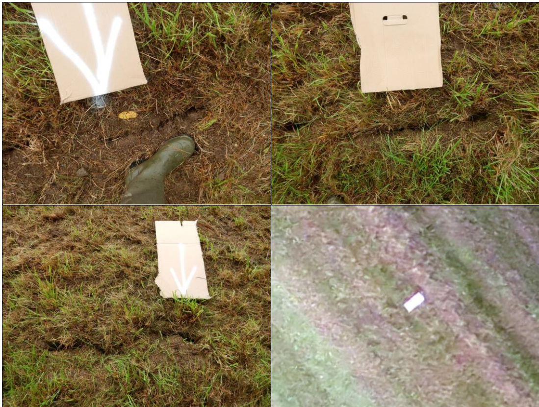
Figuur 18. Scheuren in waterkering Middelaar. Rechtsonder RPAS opname waarin geen duidelijke scheuren zijn te herkennen, (waterschap Limburg, september 2017).
